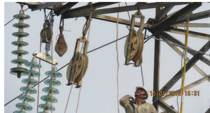
Thi công, lắp đặt dây siêu nhiệt ACCC, đường dây 110 KV Đông Anh – Võ Cường – Yên Phong
