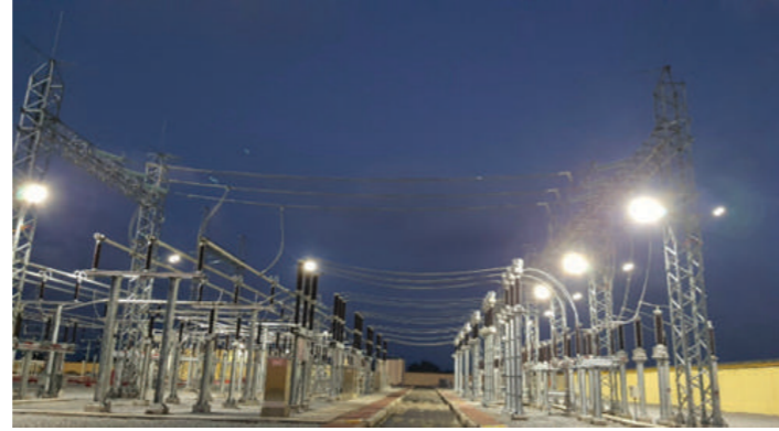
Dự án Trạm biến áp 220 KV Giá Rai ngày và đêm
